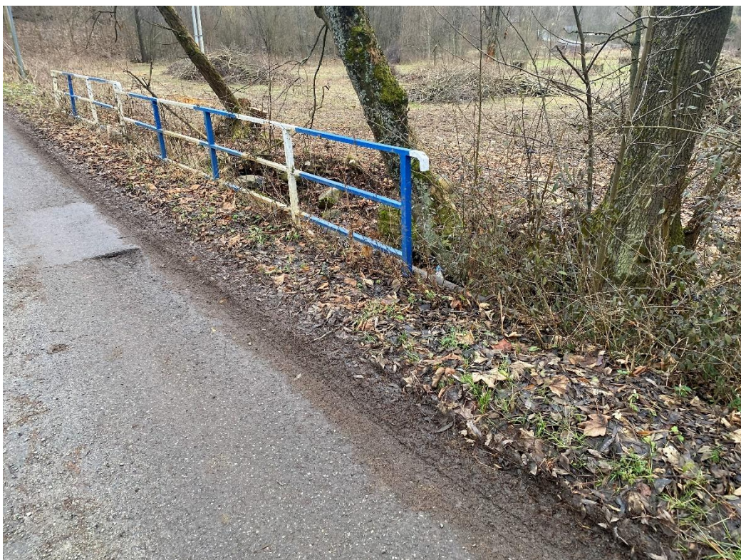
Fot. 5. Widoczne zawyżone pobocza
