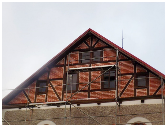
Fot. Budynek sali wiejskiej w Czerwieńczycach w trakcie prac remontowych i termomodernizacyjnych. Odnowiane są m.in. wnętrza sali i świetlicy wiejskiej.
