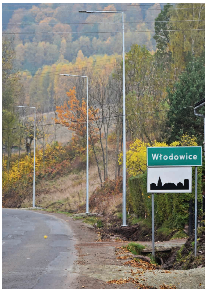
Nowe oświetlenie uliczne LED we Włodowicach. Fot. B. Adamska
